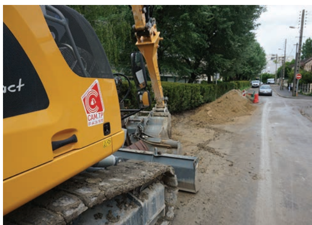
8. Rue Descartes , des travaux d'assainissement et de réfection de la chaussée sont menés jusqu'à fin juin, avec des aménagements de circulation.
