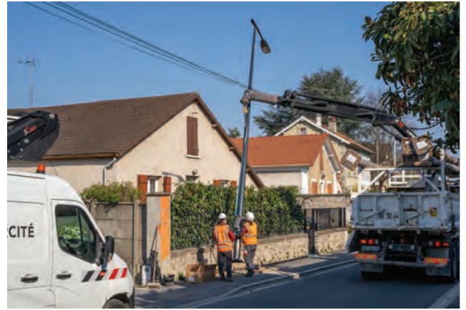
5. Pose des nouveaux candélabres avenue du Général de Gaulle (entre la rue de Ruzé et la place Pietrasanta).
